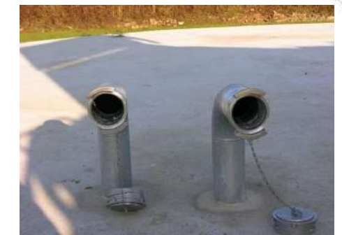
Deux colonnes d'aspiration de 100 mm sur une réserve d'eau enterrée
