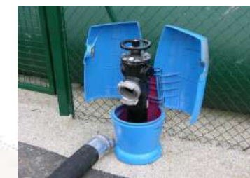
Poteau d'aspiration de 100 mm sur une réserve d'eau souple
