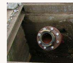
Bouche d'aspiration de 100 mm sur une réserve d'eau enterrée
