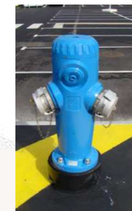
Poteau d'aspiration à réseau sec de 150 mm, muni de deux sorties de 100 mm et d'un Airclap. Pas de carré ni de volant de manœuvre
