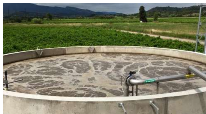
Image 15 : Station d'épuration de Conilhac-Corbières ; SOLIHA méditerranée, 2023
