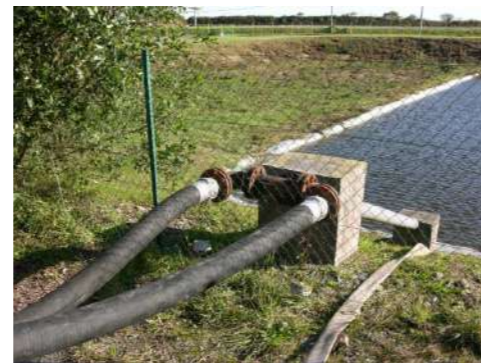
Réserve d'eau ouverte avec 1 colonne de 150 mm alimentant 2 sorties de 100 mm
