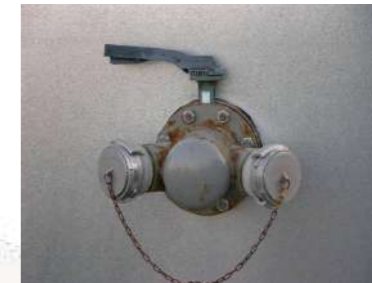
Prises directes de 100 mm sur réserve
